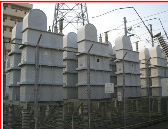
電力用コンデンサ (SC : Static Capacitor)
