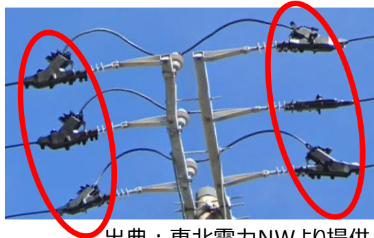
高压電線の引留箇所
