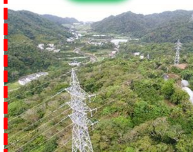
写真：架空電線路全景
