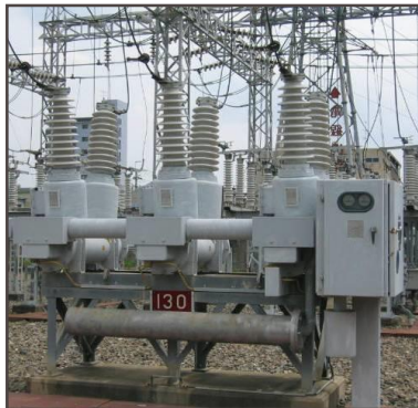
77kVガス遮断器
