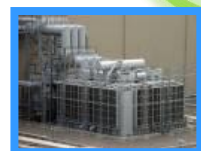
発電所向け大容量 変圧器
