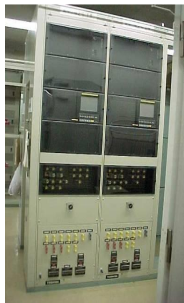
保護継電装置
