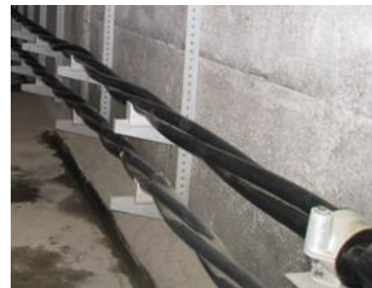
写真：地中ケーブル
