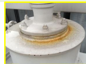
写真：油密部からの漏油
