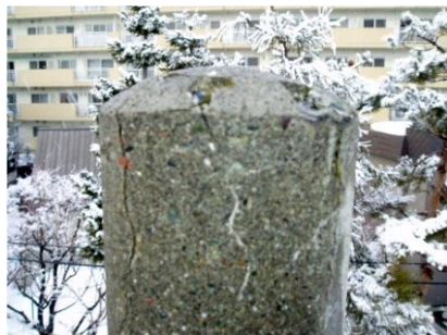
頭部剥離対策
