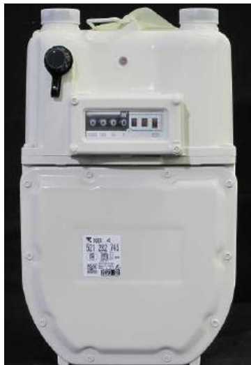
4号メーター (膜式ガスメーター)
