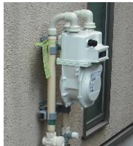
4号メーター (膜式ガスメーター)
