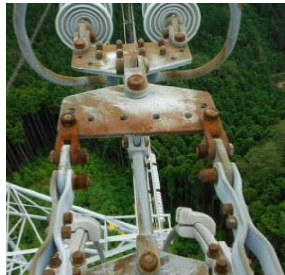
【架線金具，スパーサーの劣化状況（腐食）】
