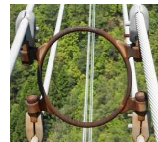
スペーサーの腐食
