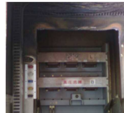
絶縁破壊によるスイッチギヤ内の焼損
