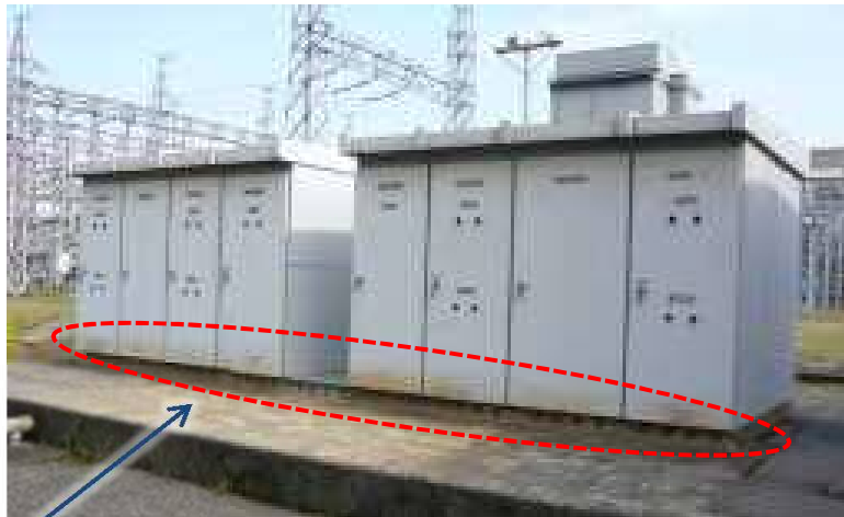
【腐食劣化状況】
