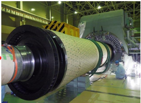
発電機の分解点検
