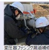
変圧器ブッシング漏油補修
