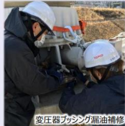
変圧器ブッシング漏油補修
