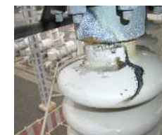
2004年 台風18号におけるがいし閃絡被害 (門司ss220kV1号母線)
