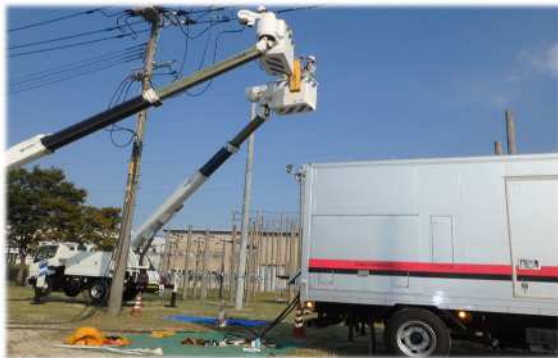
四国電力送配電の電源車 による応急送電訓練
