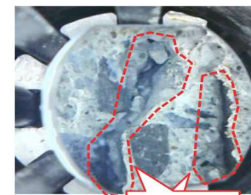
小口径空洞内撮影装置によるひび割れ個所の撮影画像
