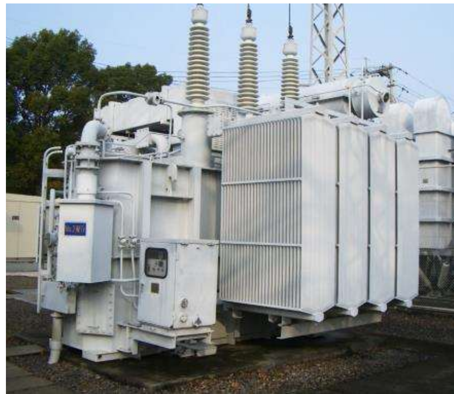
◇変圧器の施設状況
