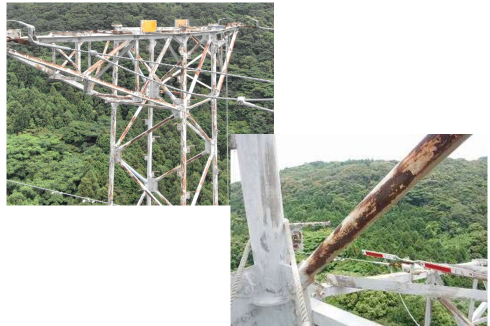
○ 鉄塔部材の劣化状況
