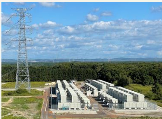
I期蓄電池 外観▶
