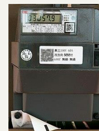
スマートメーター
