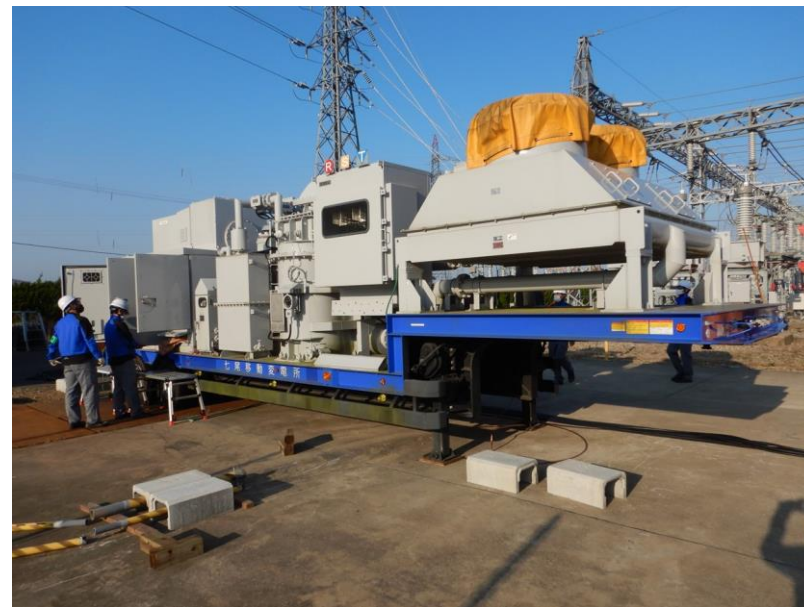
開閉装置一体型移動用変圧器
